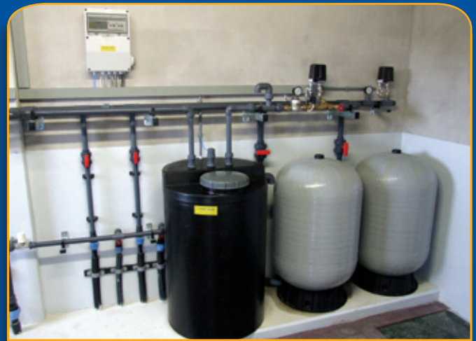
installatie voor ondergronds ontijzeren
